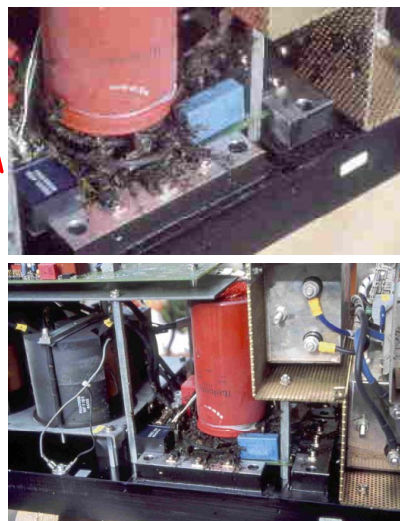
Daños por sobretensión causados por un impacto indirecto de un rayo
