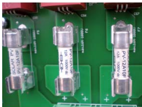
Fusibles en la caja de conexión
