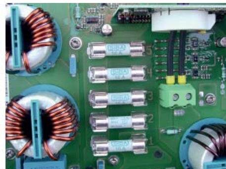
Fusibles en el inversor
